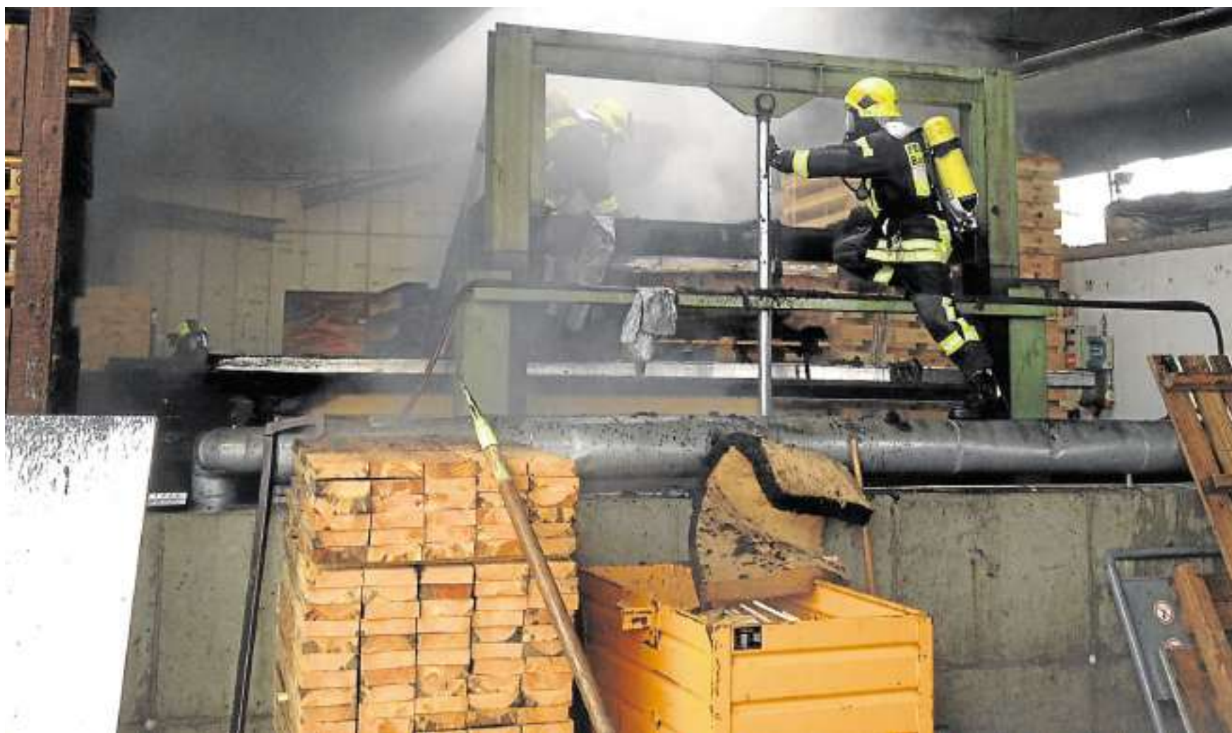
Die Feuerwehr musste das Dach aufbrechen, weil darin Isoliermaterial schmolte.
